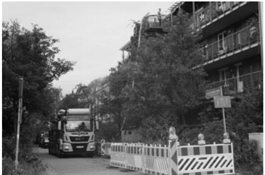
Bei grundlegender Flachdach-Sanierung kam ein sehr lautes Gerät mit Saug- und Blastechnik zum Einsatz, um das Gründachsubstrat per Schlauch zu entfernen. Foto: SVV
